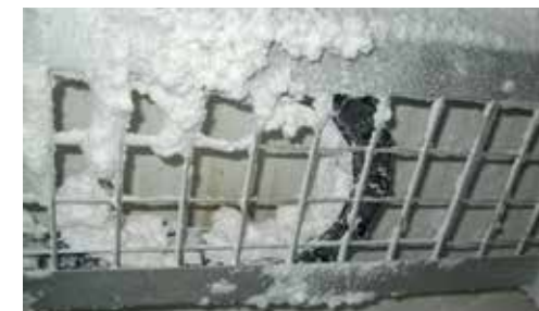
In diesem Schockfroster wird eine frostresistente e-kette® mit verschiedenen Schläuchen und Ketten geführt. This shock freezer in the food industry uses a frost-resistant e-chain® with various hoses and chains.
