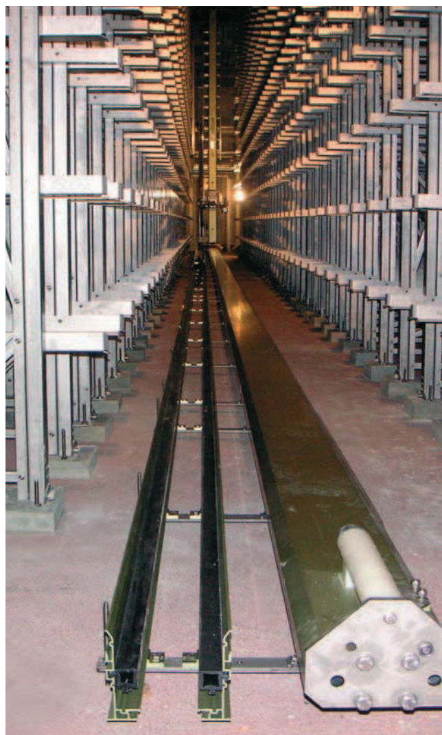
冷凍庫内でのアルミ製ガイドチャンネルのロングストローク使用
