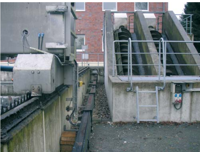
Bild FA0206-04: igus GmbH, Köln Die Energiezuführung versorgt u.a. den Antriebsmotor des Räumers sowie drei Pumpen mit Energie und Steuersignalen.
