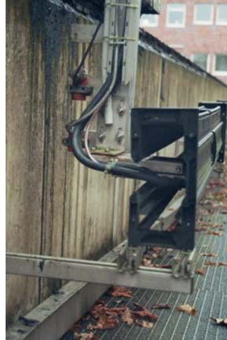
Bild FA0206-05: igus GmbH, Köln Auch bei der Einspeisung am Festpunkt der Führungsrinne konnte igus auf standardisierte Module zurückgreifen.
