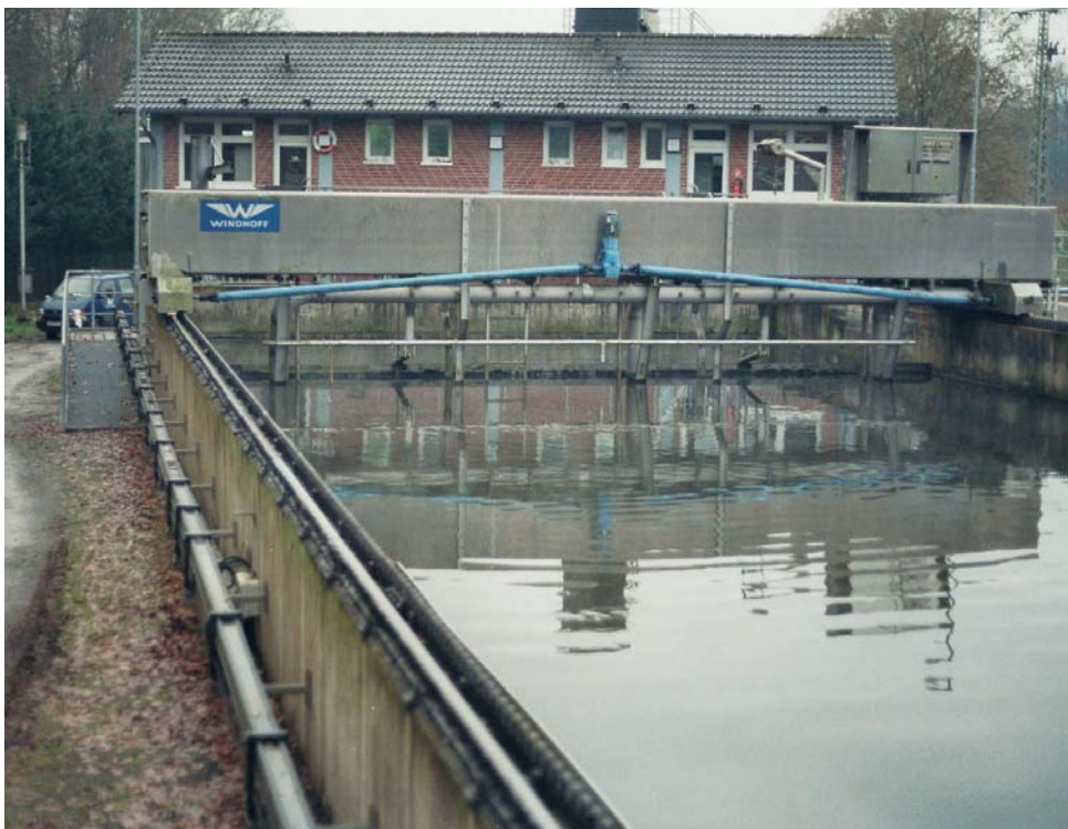
Bild FA0206-01: igus GmbH, Köln Der Räumler bewegt im 24-Stunden-Betrieb sich auf dem 38 Meter langen Nachklärbecken. Die Energieversorgung erfolgt über das LBT Flizz-System.
