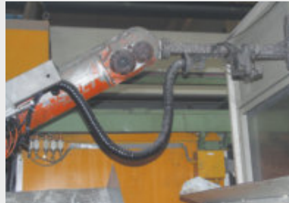
Triflex® R in einer Magnesium-Druckgiesserei - Ausfallsicher trotz Hitze, Schmutz, Öl und Späne
