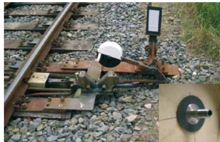
Weichenbetätigung und Führung für eine 180°-Drehbewegung mit einem Flanschlager aus iglidur® G Points activation and guidance for a 180 degree rotating motion with a flange bearing made of iglidur® G
