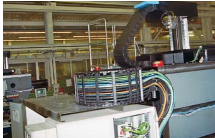
Platz sparen: Die x-Achse der Energiekette liegt auf der oberen Maschinenabdeckung Save space: Horizontal x-axis of E-Chain® on top of machine cover
